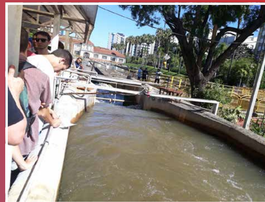
Estudantes visitam Estação de Tratamento de Água Moinhos de Vento do Departamento Municipal de Água e Esgoto (DMAE) de Porto Alegre
